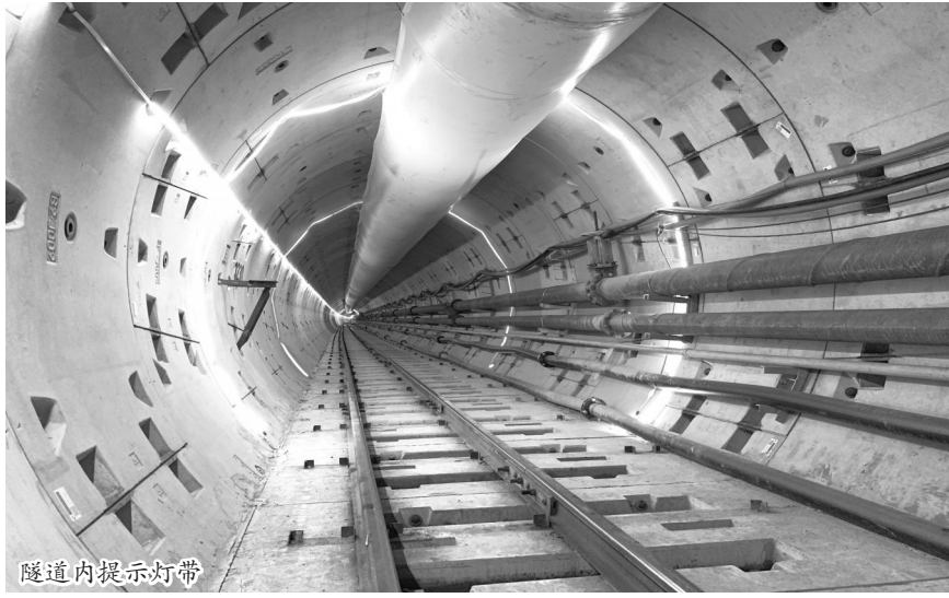
隧道内提示灯带
