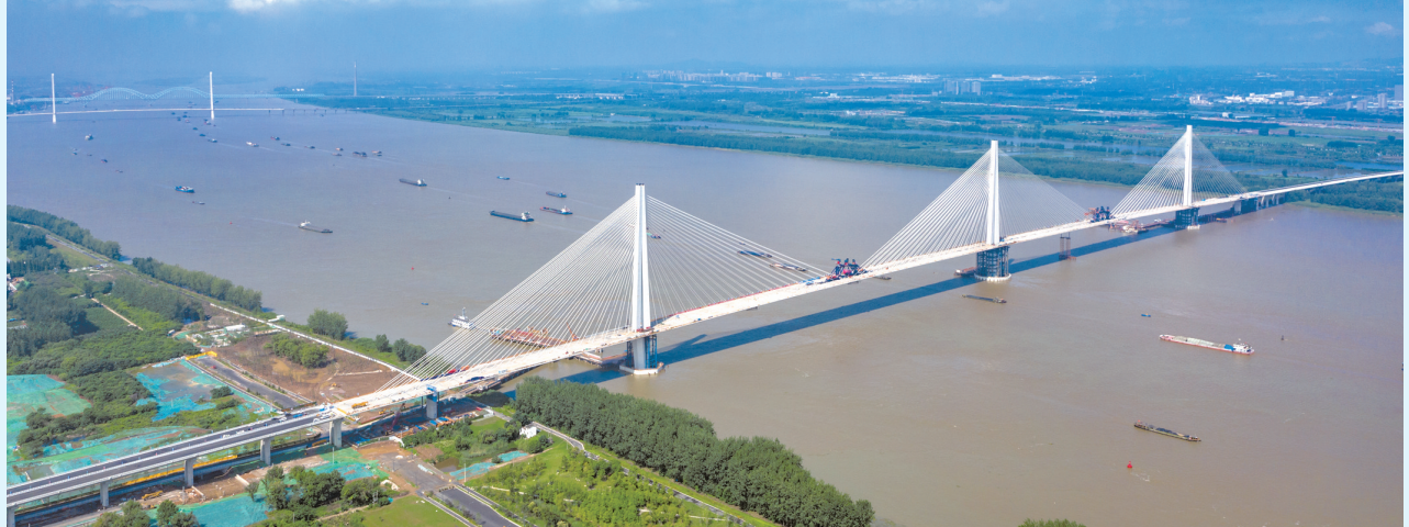
6月28日上午，随着中交二航局建设者将最后一盘粗骨料活性粉末混凝土缓缓浇筑入横向连接缝中，世界首座轻型钢混结构斜拉桥——南京长江第五大桥跨江主桥顺利合龙。
