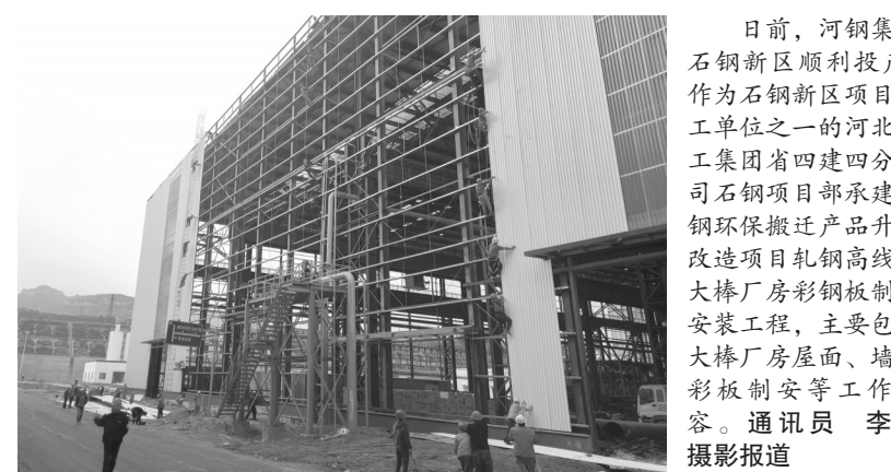
日前,河钢集团石钢新区顺利投产。作为石钢新区项目施工单位之一的河北建工集团省四建四分公司石钢项目部承建石钢环保搬迁产品升级改造项目轧钢高线及大棒厂房彩钢制作安装工程,内容包括大棒厂房屋面、墙面彩板安装等工作内容。通讯员 李佳 摄影报道
