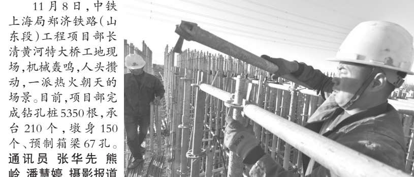
11月8日,中铁上海局郑济铁路(山东段)工程项目部长清黄河特大桥施工现场,机械轰鸣,人头攒动,一派热火朝天的场景。目前,项目部完成钻孔桩5350根,承台210个,墩身150个,预制箱梁67孔。通讯员 张华先 熊岭 潘慧婷 摄影报道
