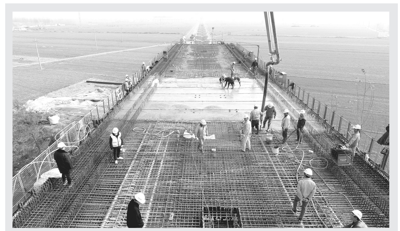
11月8日,国家重点工程郑济铁路中济上海局郑济铁路(山东段)工程项目部长清黄河特大桥工地现场,桩基、承台、墩身、连续梁、箱梁预制等施工机械轰鸣,人头攒动,一派热火朝天的大干场景。广大员工围绕“决战四季度,确保全年生产任务完成”劳动竞赛活动,全面掀起大干高潮,加快工程建设。截至目前,项目部标段完成钻孔桩3530根,承台210个,墩身150个,预制箱梁67孔。
