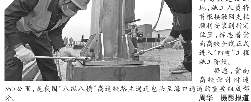
近日,在广西南宁市兴宁区邕武路附近的贵南高铁建设工地,施工人员将首根接触网支柱顺利安装到指定位置,标志着贵南高铁全线正式进入“四电”工程施工阶段。
