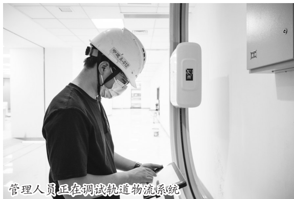
管理人员正在调试轨道物流系统
