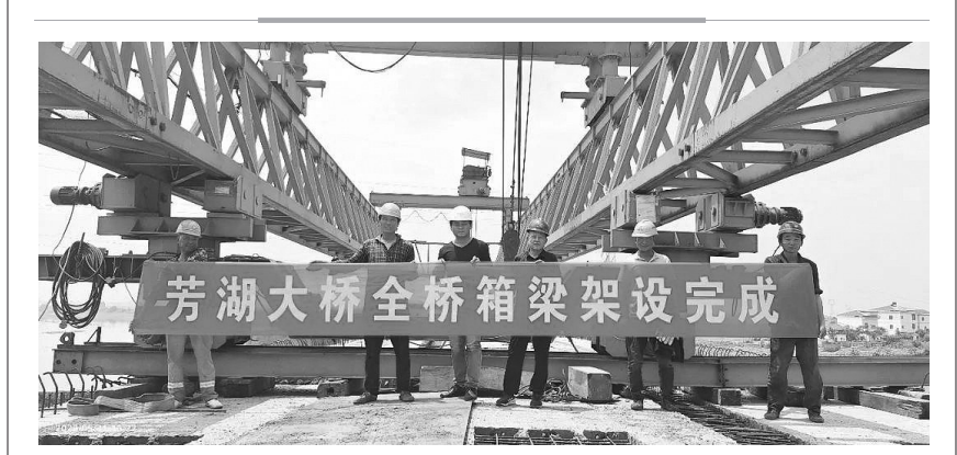
近日,随着芳湖大桥最后一片中梁稳稳落在盖梁支座上,大桥全部架设完毕。这标志着江西建工交通建设有限责任公司所施工的彭泽县太湖湖、芳湖湖区综合治理工程全线贯通。 芳湖大桥位于江西省九江市彭泽县芙蓉墩镇,总长381米。 通讯员 姜玉峰 刘毅 摄影报道
