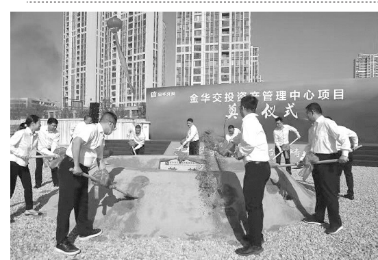
10月24日上午9时,广宏建设新承接金华交投资产管理中心项目开工奠基仪式在浙江金华举行。金华市婺城区委书记高峰宣布项目开工。金华市交投集团党委书记、董事长程继军携班子成员,婺城区委常委、常务副区长吕良勇,区政府党组成员吴见孙等为项目奠基。 通讯员 胡丹云 摄影报道
