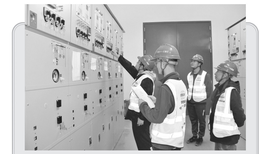
10月26日,江苏苏州轨道交通S1线顺利实现全线“电通”节点目标。
