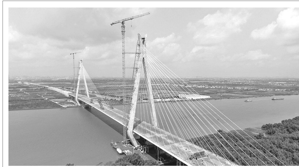
近日，由中铁大桥局承建的中南高速洪奇门特大桥顺利合龙。洪奇门特大桥全长1126米，为主跨520米的双塔双索面钢箱梁斜拉桥，是中南高速项目的关键控制性工程。中南高速项目是粤港澳大湾区核心区互联互通的特大型桥梁工程和跨珠江通道体系的重要组成部分，与深中通道无缝对接，串联起大湾区核心区东西南北大通道。该项目总投资额超200亿元，计划2024年与深中通道同步建成。邓华 摄影报道
