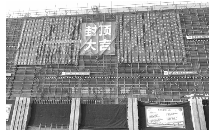
近日, 随着最后一立方米混凝土浇筑完成, 中能建建筑集团网滁滁客户服务中心用房主体结构顺利封顶。至此, 该项目正式转入砌体、二次结构及装饰装修施工阶段。
