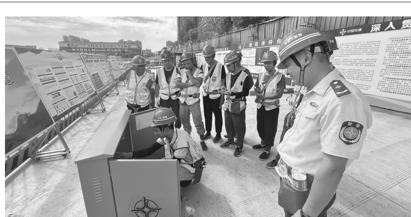
“各位参赛选手注意, ‘技能比武’期间请大家严格遵守竞赛规则……”6月11日上午9点, 在四川省资阳市中交二航局中交锦上项目工地上, 伴随着气温的升高, 建筑工地上技能比武的气氛也更加火热。4名来自劳务班组的电工摩拳擦掌, 进行配电“大比拼”。
