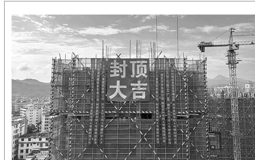
近日, 随着首栋楼房的顺利封顶, 江西建工第三建筑有限责任公司承建的江西省赣州市赣县区城南新区棚户区安置房建设项目(城投·金和书院)建设取得突破性进展。
