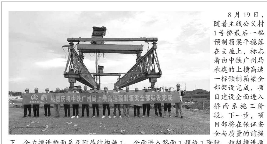
8月19日，随着主线义村1号桥最后一根预制箱梁平稳落在支座上，标志着由中铁广州局承建的上高铁路全部预制箱梁全部架设完成，项目建设全面进入桥面系施工阶段。下一步，项目部将在保证安全与质量的前提下，全力推进桥面系及附属结构施工，全面进入路面工程施工阶段，积极推进项目的高效建设，确保如期通车。通讯员 刘阳 吴主宽 摄影报道
