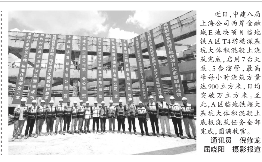
近日，中建八局上海公司西岸金融城E地块项目T4塔楼深基坑大体积混凝土浇筑完成，启用7台天泵、5套溜管，最高峰每小时浇筑方量达900立方米，日均突破万立方米。至此，A区临地超深大体积混凝土浇筑任务全部完成，圆满收官。通讯员 倪修龙 屈晓阳 摄影报道
