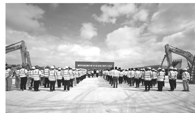
7月26日,浦东机场四期扩建飞行区主体工程开工仪式在西南远客机坪施工现场举行。上海机场集团党委书记、董事长秦云,上海宝冶党委副书记、总经理张文等出席仪式。
