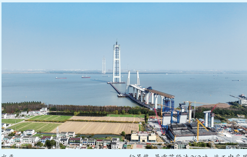
南航道桥两座主塔均设有三道横梁，本次合龙的上横梁分为三个节段进行吊装，最重节段达262吨，施工中采用全球首台万吨级塔吊进行安装，并运用全断面焊接连接工艺。在合龙段安
